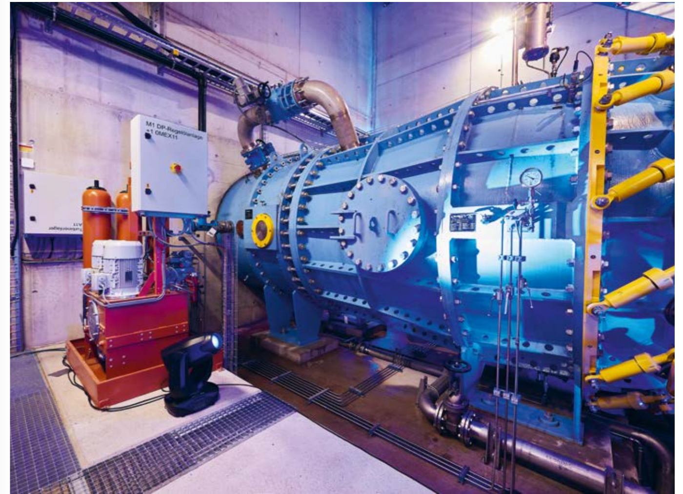
Turbine am Tag der offenen Tür im Rampenlicht.
